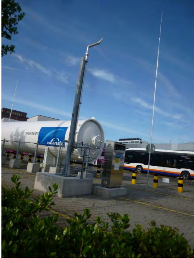
H2 Tankstelle (Hauptspeicher) ESWE Wiesbaden
